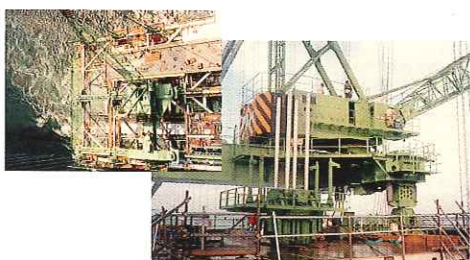
本四橋公団/大鳴門橋 橋桁仮設工事ハンガーロープ引き込み用 センターホール尺取りベアロック
